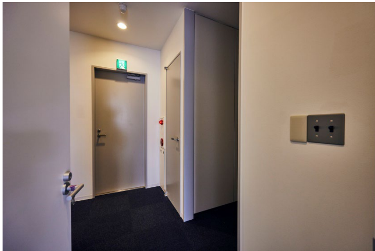
消火器・非常口
